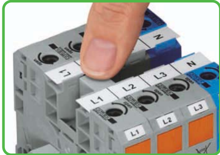
Brücken benachbarter Klemmen mit Querbrückern in der Klemmenmitte.
