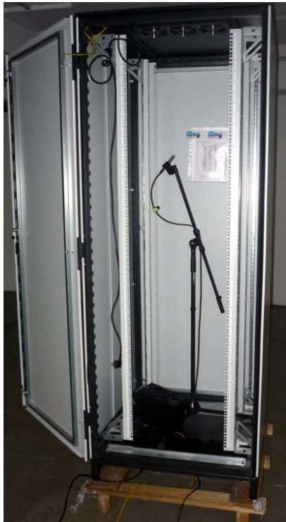
Geräteschrank Innenansicht ohne zusätzliche Schalldämmung
